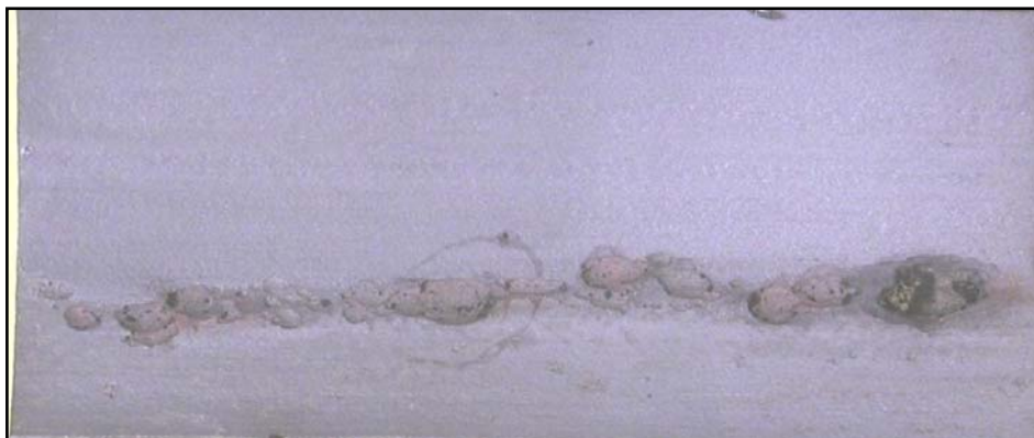
Bild 15: Rohrrinnenoberfläche eines Fallrohres unmittelbar hinter der Trommel vor (rechts) und nach der Beizung (links)
